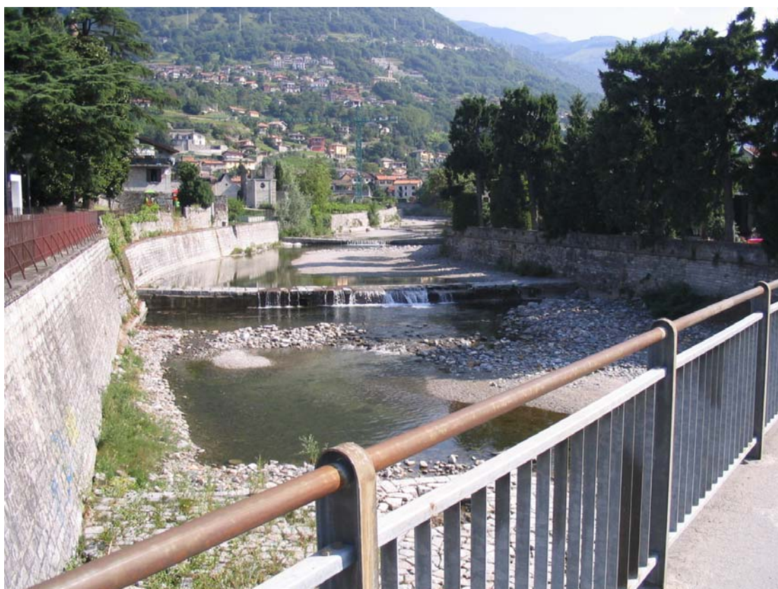
Foto 4 – Alveo a monte del ponte della S.S.Regina - soglie n.1 e n.2 (vista da valle verso monte)
